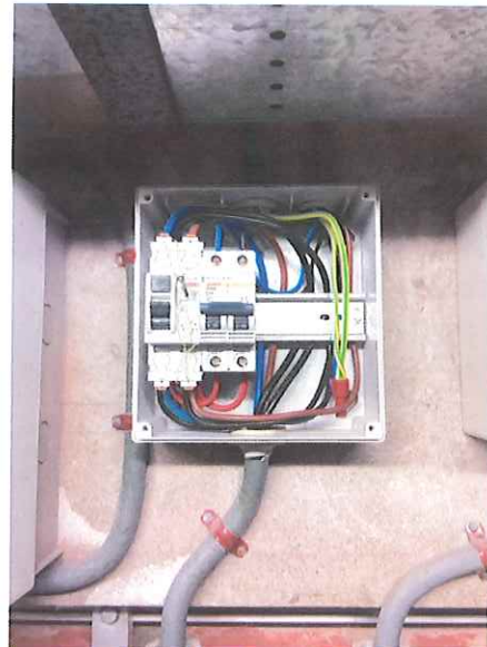
( Tableau électrique - intérieur )
